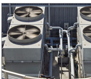
FAN AND PUMP
